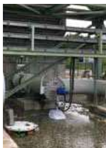
T形鋼管製 屋外水平Lフロー配管 モータ付自動制御運転化
