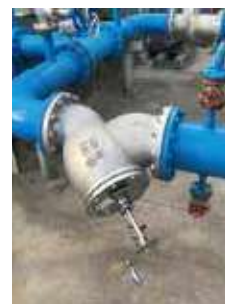
Y形鋳物製 屋外設置水平配管
