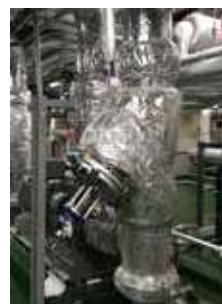
Y形鋳物製 屋内設置縦配管
